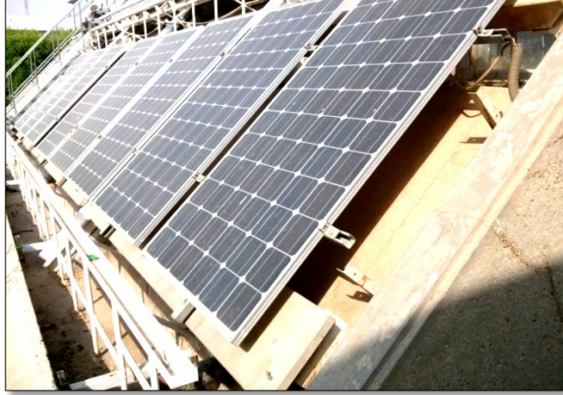
شكل (2) مصفوفة الالواح الشمسية الكهروضوئية على واجهة المبنى
